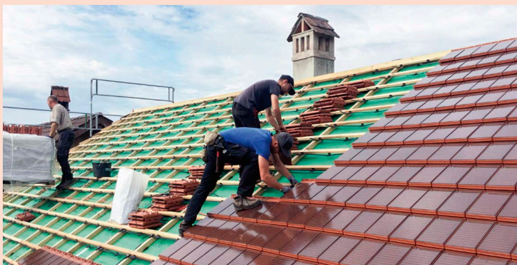
Verlegen von Photovoltaik-Dachziegeln auf dem Haus an der Bahnhofstrasse 12. Foto: Freiluft Architekten.
